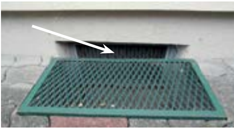
Ungesicherter Lichtschacht – Absturzgefahr
