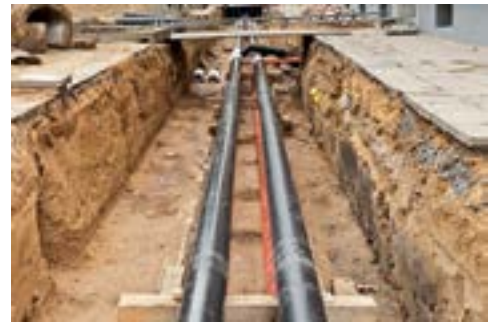
Ungesicherte Baugrube – kein Entkommen
